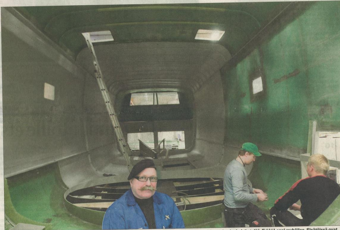
Kohtalainen konekoppa. Neljäskymmenesviihes tuulivoimalan kuorirakenne lähtee sunnuntai-iltana Virtasalmen haiskaväeltä kohti etelää, Erkki Lappi myhäilee. Sisätöissä ovat Teemu Ylönen ja Sauli Musakka. KUVAT: MARI PETÄJÄ
